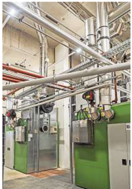
Das Herzstück des Heizkellers – die Holzschnitzelkessel und das beeindruckende Röhrensystem.
