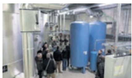
Speicher und Pumpengruppe in der Energiezentrale in den Räumlichkeiten der Hector Egger Holzbau AG
